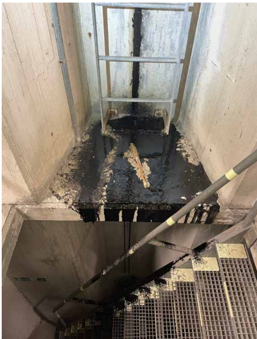
Bitumenläckage från en dilatationsfog inuti en anläggning. Bild från platsbesök.
