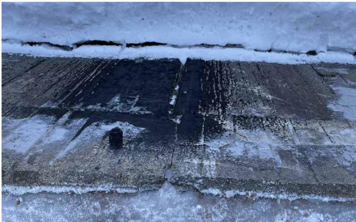
Bitumenläckage längs en dammkropp på uppströmssidan. Bild från platsbesök.
