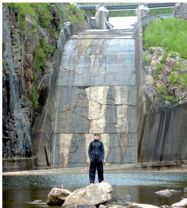
Kristoffer Pettersson framför den skadade utskovskanalen
