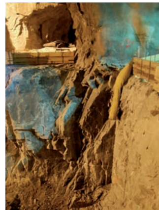
Bild 2. Stabilitetsrisk i maskinsalens ena vägg.
