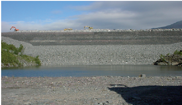
Västra dammen i augusti 2005 med den nyanlagda tåbanken och det pågående förstärkningsarbetena på krönet. Foto Claes-Olof Brandesten
